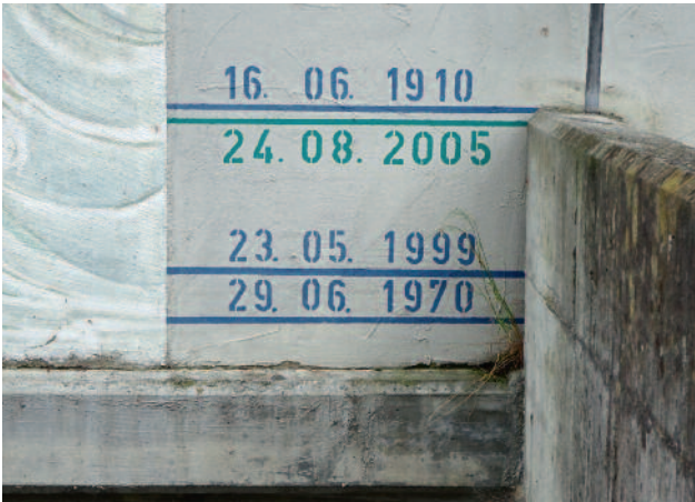
Hochwassermarkierungen am Fischereigebäude
