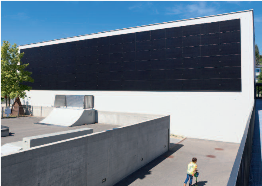
Neu installiert: Photovoltaik-Anlage an der südlichen Fassade der Sporthalle Hofmatt.
