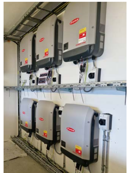
Die neuen Komponenten der Hauptverteilung sind montiert.
