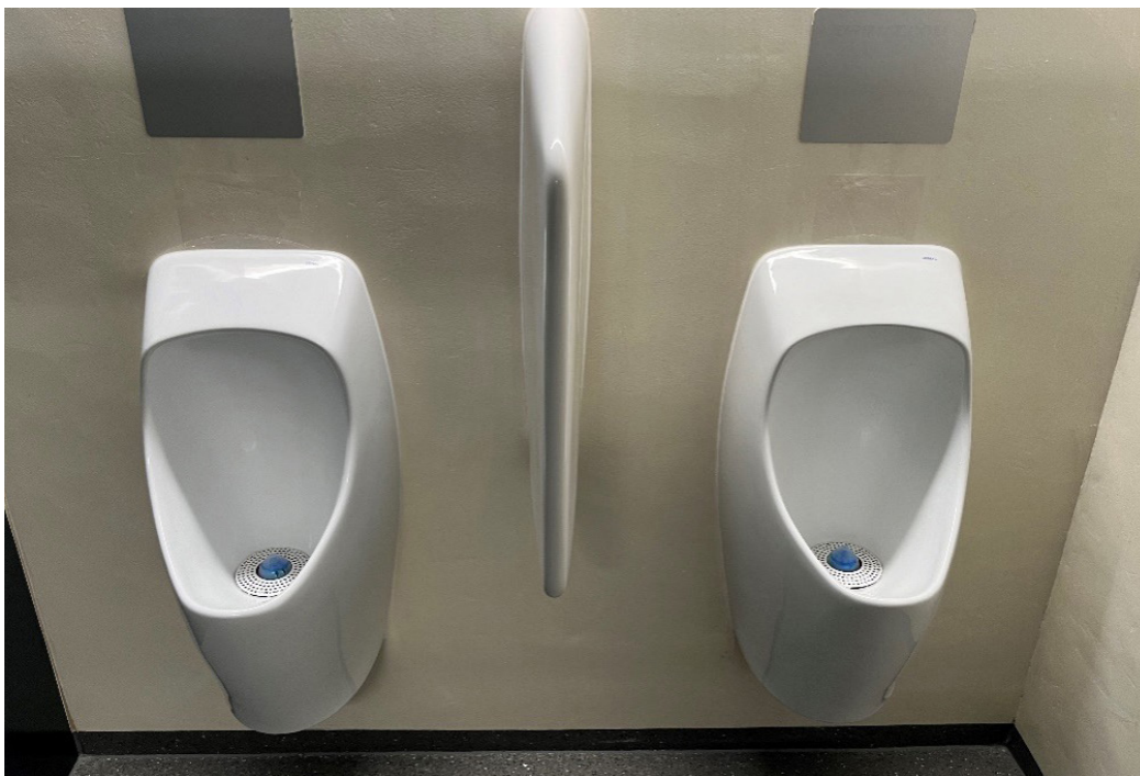
Die Gemeinde geht mit gutem Beispiel voran: Die neu installierten 0-Liter-Urinale sparen kostbares Trinkwasser und senken die Betriebskosten.
