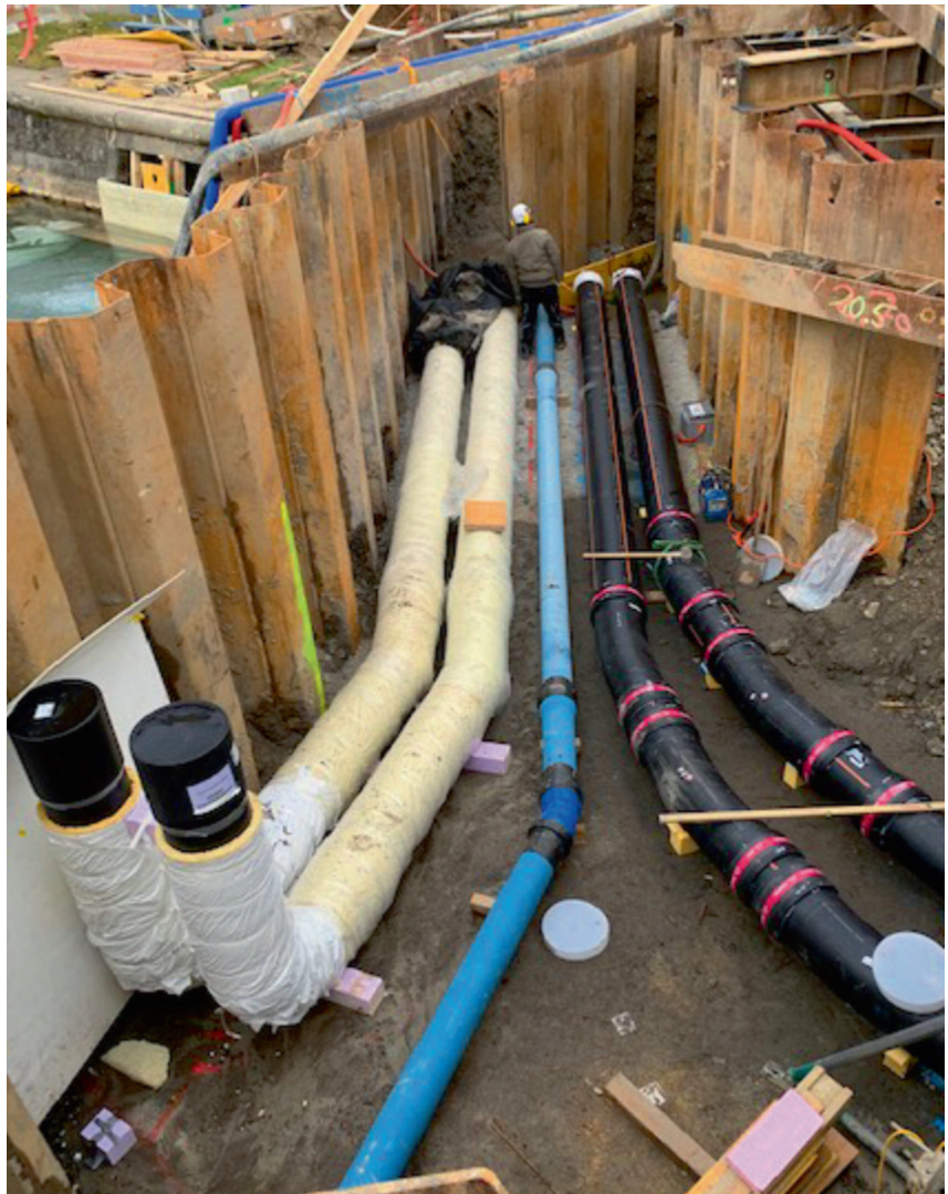
Baustelle beim Pumpwerk auf der Küssnachter Quaianlage: In der Bildmitte die blaue Transportwasserleitung der Wasserversorgung Meggen.
