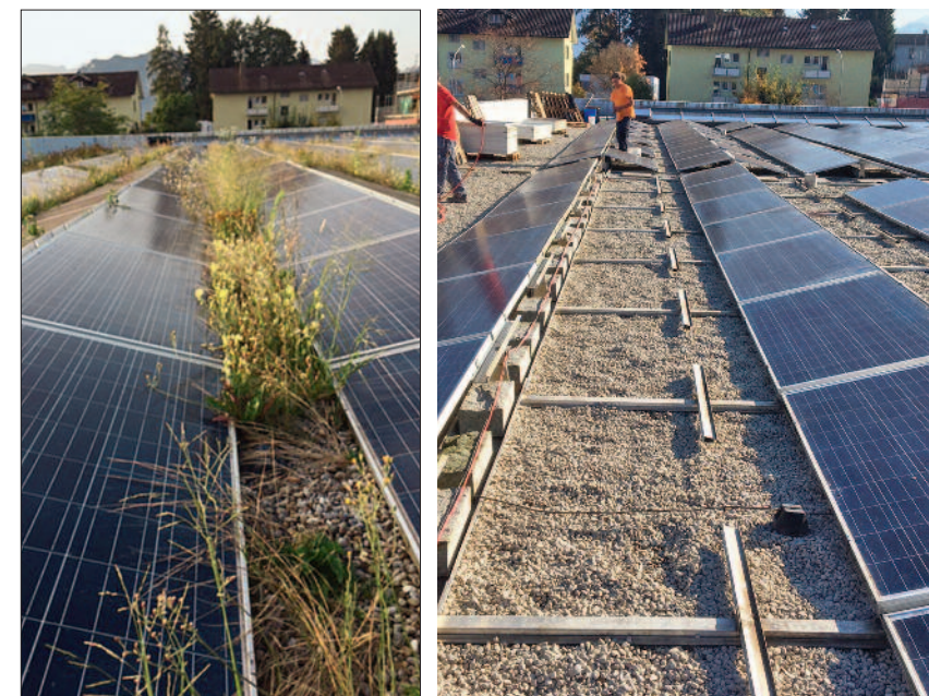
Vorher – nachher: Rundkies statt extensive Begrünung auf dem Dach der Sporthalle Hofmatt.
