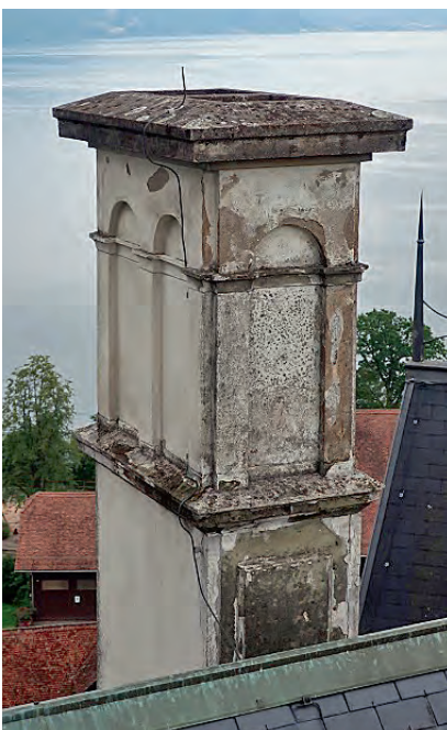
Schäden am Dach Schloss Meggenhorn: Zustand Kamin Süd 2020.
