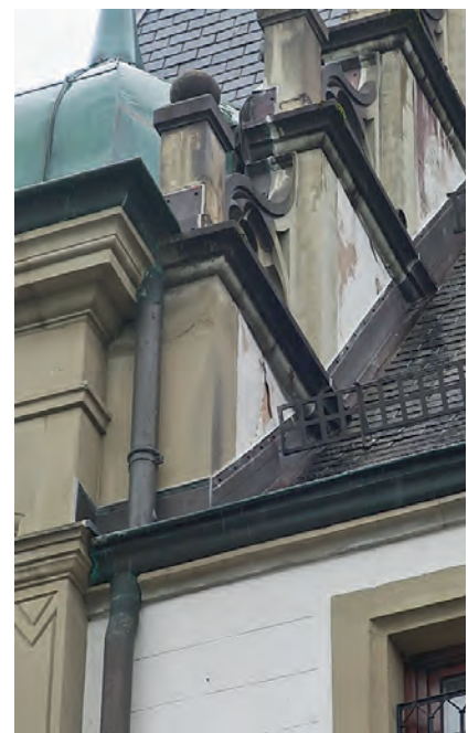
Putzschäden und in der Folge durchnässtes Mauerwerk.
