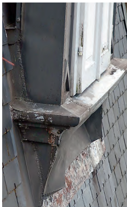
Alte, mehrfach geflickte Blecharbeiten Südturm Lukarne.
