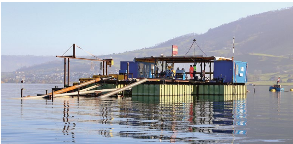
Erneuerung Transportwasserleitung Lauerz–Meggen, Etappe B: Zwischen Arth und Immensee wird die Leitung in den Zugersee gelegt, so wie dies bei der Etappe A zwischen Küssnacht und Merlischachen (im Bild) der Fall war.
