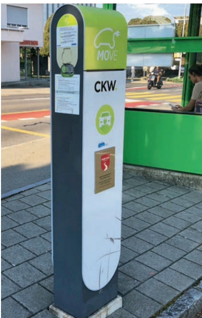
Die bestehende Ladestation der CKW auf dem Parkplatz Schlössli.
