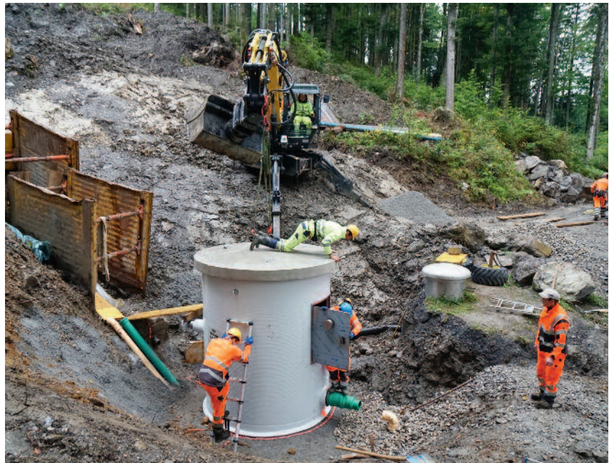
Arbeiten im Quellgebiet der Wasserversorgung Meggen in Lauerz: Installation einer neuen Brunnenstube.
