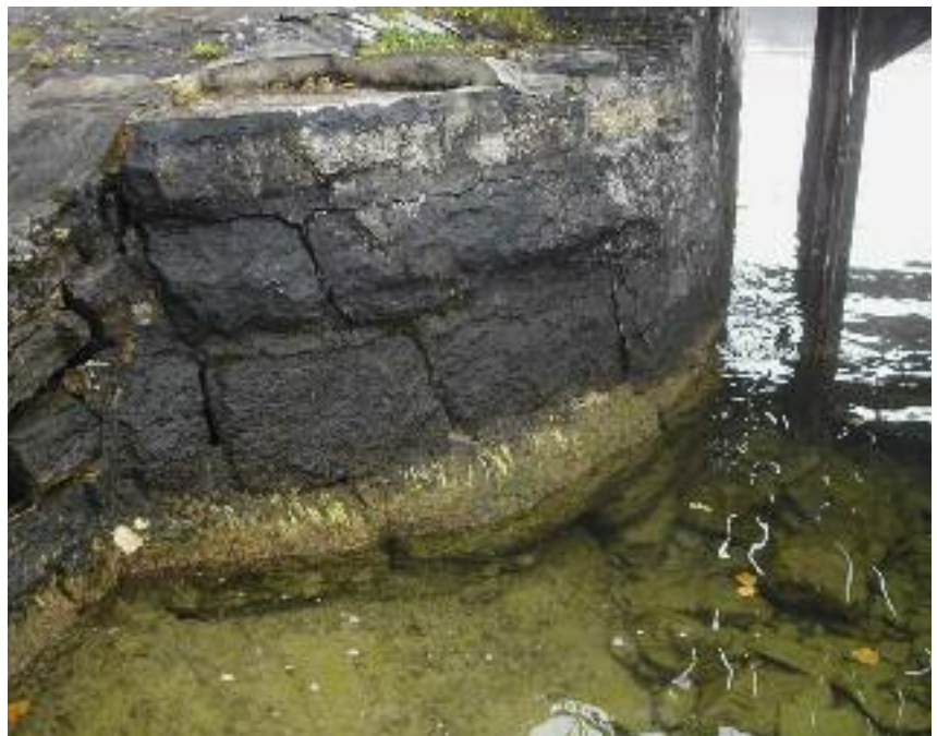
Leist Übergang der Ufermauer, südseits: Risse und Bewegungsschäden.
