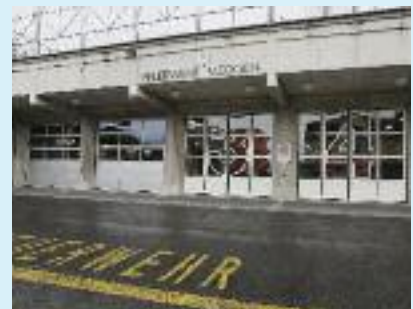
Bei Halbzeit der Arbeiten: Links die neuen Sektionaltore, rechts (Nr. 3 und 4) die alten Tore. rü
