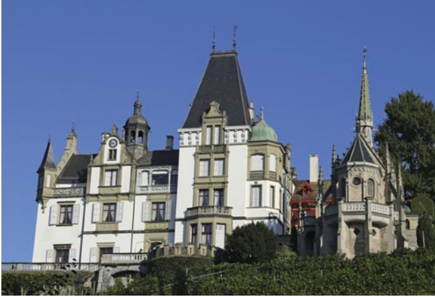
Beim Schloss Meggenhorn hat sich gezeigt, dass die Dachkonstruktion und die Dachabdeckung stark sanierungsbedürftig sind.
