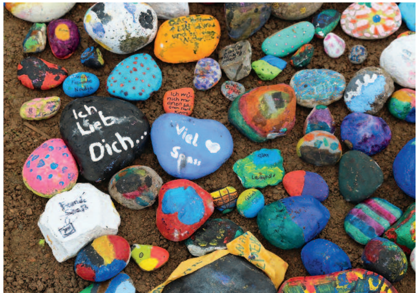
Rund 400 Primarschülerinnen und -schüler legten ihre bunt bemalten Steine vor der Grundsteinlegung in die Baugrube.
