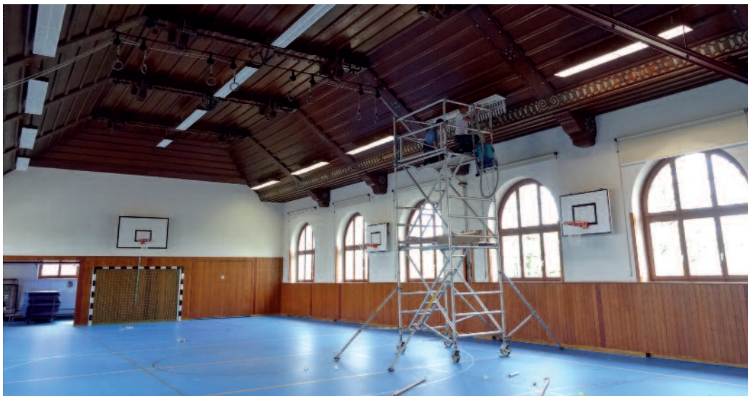
In der Turnhalle Zentral wurde die Beleuchtung auf LED umgestellt, womit der Stromverbrauch um zwei Drittel gesenkt werden kann.
