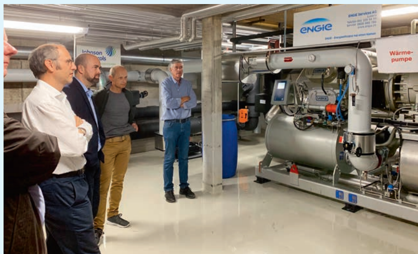
Die Mitglieder der Energiekommission Meggen besichtigten im September den Seewärmeverbund in Weggis und bekamen dabei einen positiven Eindruck vom Potenzial Seewasser-Energie.
