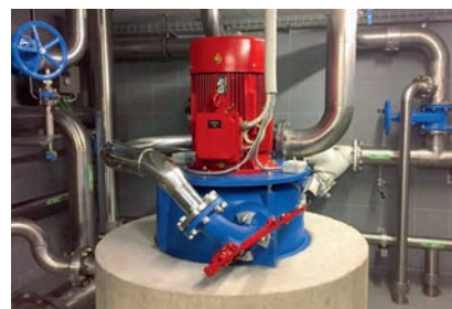
Ruedi Imgrüth Leiter Planung/Bau Das Kleinkraftwerk im Reservoir Lauerz.
