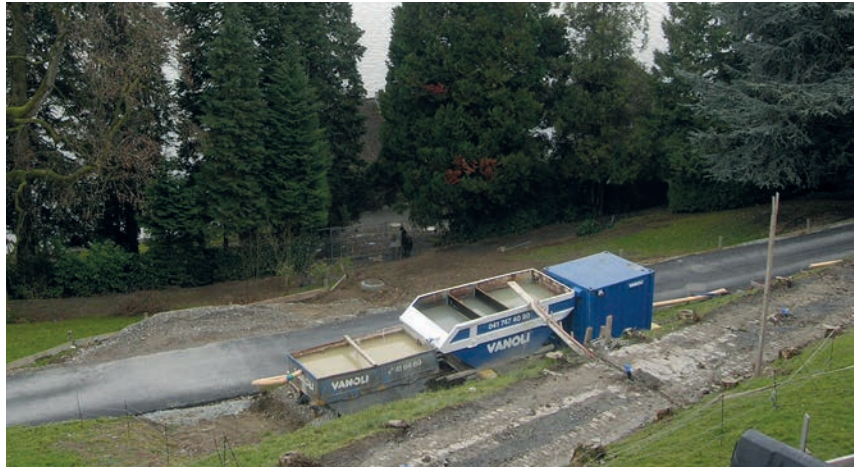
Nach dem Auffangbecken für das Grobmaterial sind gemäss SIA 431 Entwässerung von Baustellen zusätzliche Absetzbecken erforderlich.
