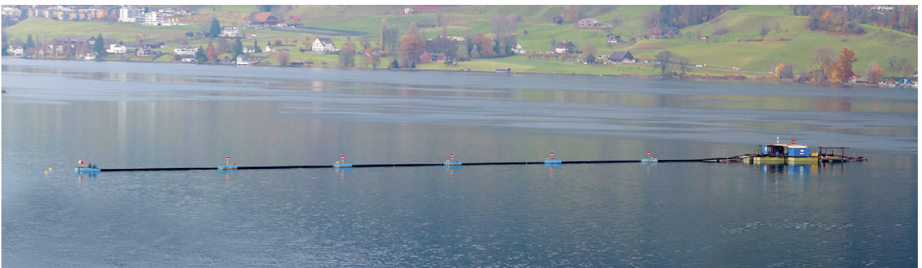
Zwischen Küssnacht und Merlischachen wurde ein 4 km langer Abschnitt der Transportwasserleitung auf den Seegrund gelegt. Das Bild zeigt die Vorbereitungsarbeiten in Merlischachen mit dem langen Führungsrohr für das Absenken der Transportwasserleitung.
