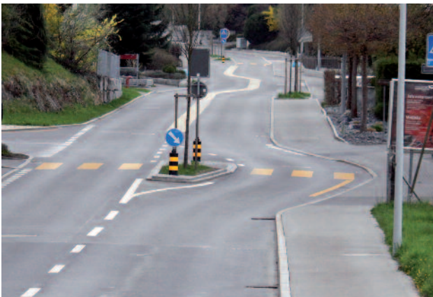
Der Betonmittelstreifen auf der Kreuzbuchstrasse hat sich nicht bewährt. Er soll durch Belag ersetzt werden.
