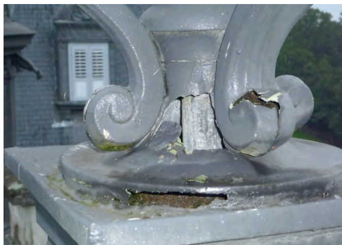
Fotos von Schäden zeigen, dass die Sanierung des Dachs von Schloss Meggenhorn dringend notwendig ist.
