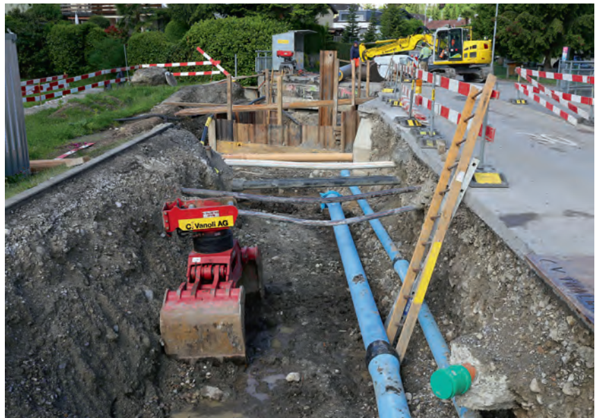
Die Unterquerung des Giessenbaches in Küssnacht stellte aufgrund der bestehenden Fundationspfähle eine besondere Herausforderung dar.
