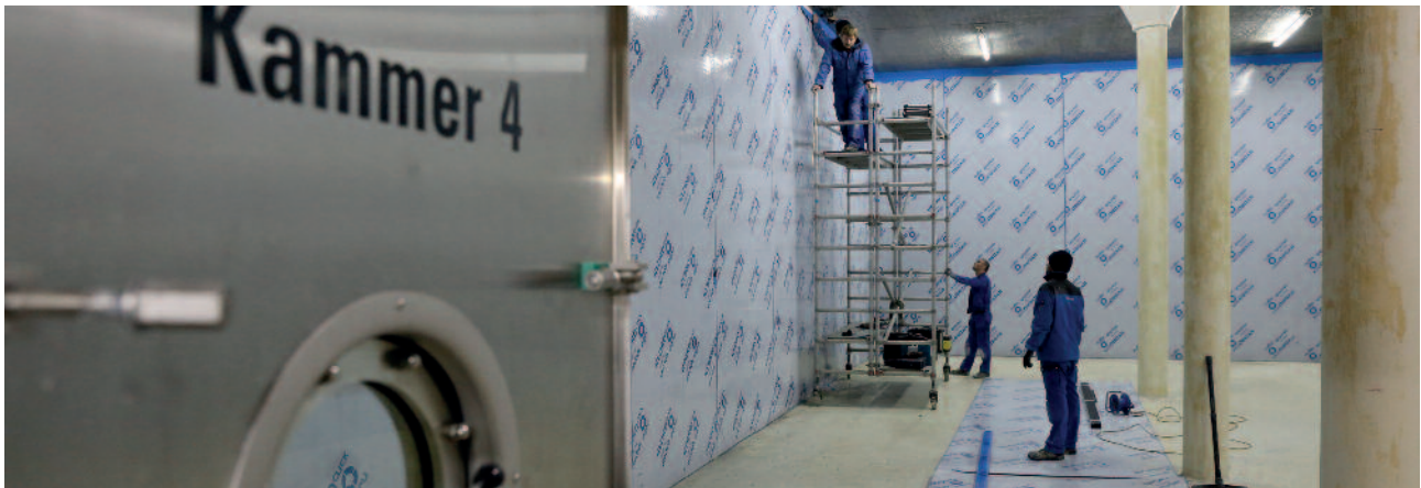
Beim Reservoir Tschädigen der Wasserversorgung Meggen müssen weitere Instandhaltungsarbeiten ausgeführt werden.
